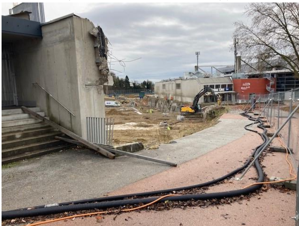
Abbildung 1: Baustelle „LASK-Arena“ am 2.12.2021 (im Hintergrund rechts die multifunktionelle Veranstaltungshalle der Stadt Linz, im Vordergrund links Gebäudeteil der alten Stadionanlage)
